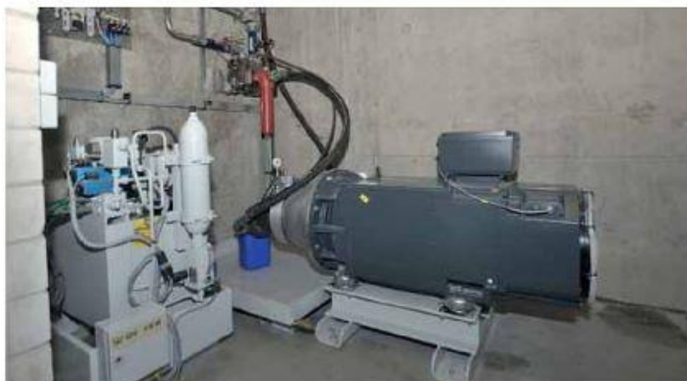
De gekoppelde generator remt de 'kleine' hydrauliekmotor (links) af. Deze meetapparatuur kan overweg met olieopbrengsten tot 600 liter per minuut.
